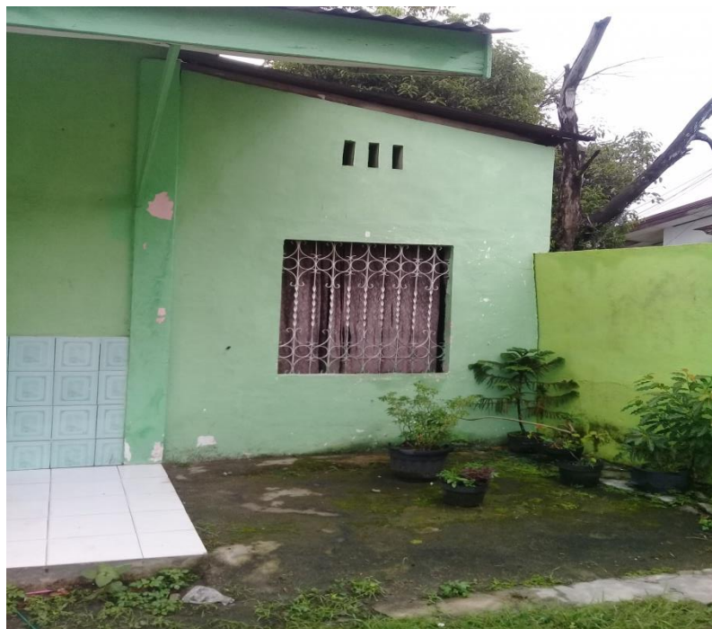
Foto kantin MTs. Al Hasanah yang sudah tidak dipakai lagi
