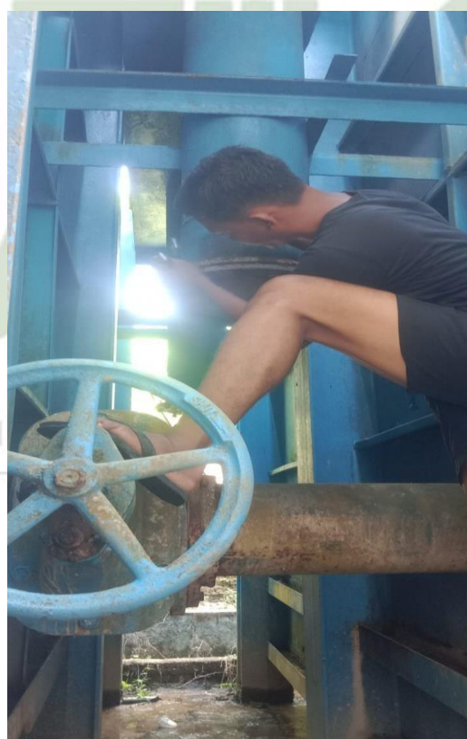
Pekerjaan karyawan pada mesin pompa air
