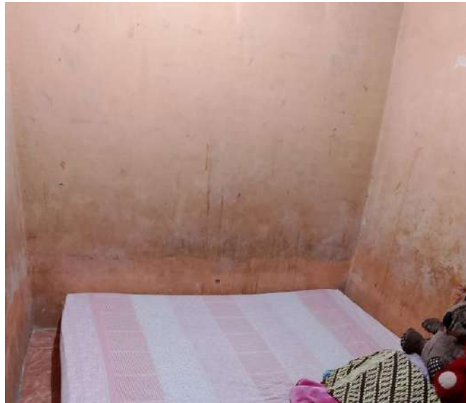
Gambar 3. Kamar yang tidak memiliki Ventilasi
