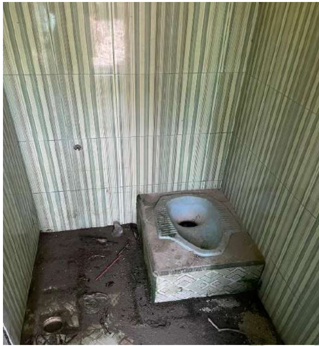
Gambar 3. Jamban/WC yang sudah tidak layak Pakai
