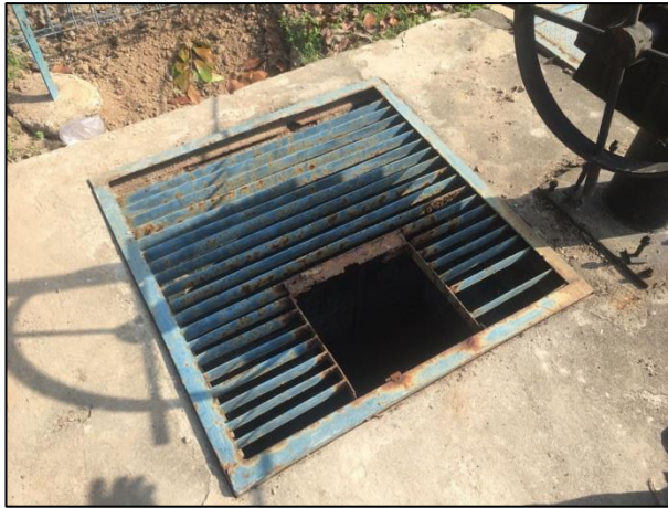
Gambar 6. Inlet (Sumber: Dokumentasi Pribadi)
