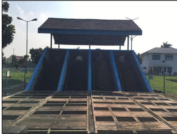
Gambar 7. Screw Pump (Sumber: Dokumentasi Pribadi)
