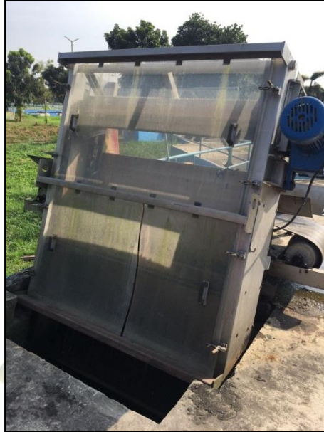
Gambar 9. Fine Screen (Sumber: Dokumentasi Pribadi)
