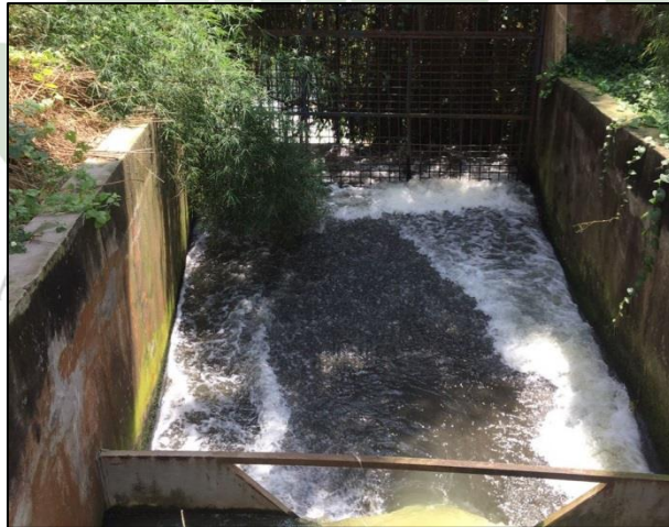
Gambar 16. Outlet ( Sumber: Dokumentasi Pribadi )
