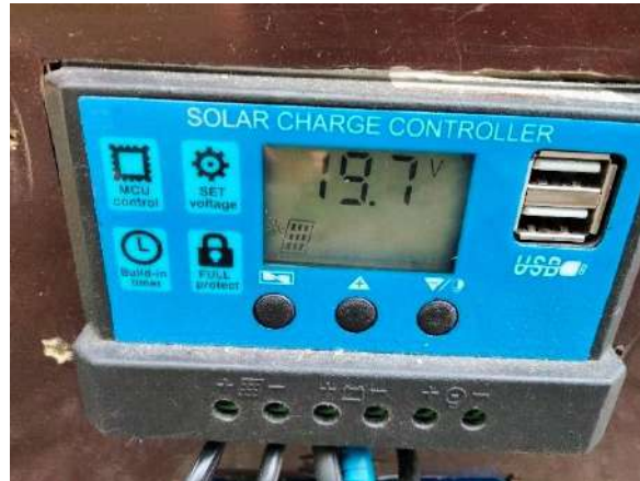
Nilai Tegangan Panel Surya yang Tampil Pada display SCC
