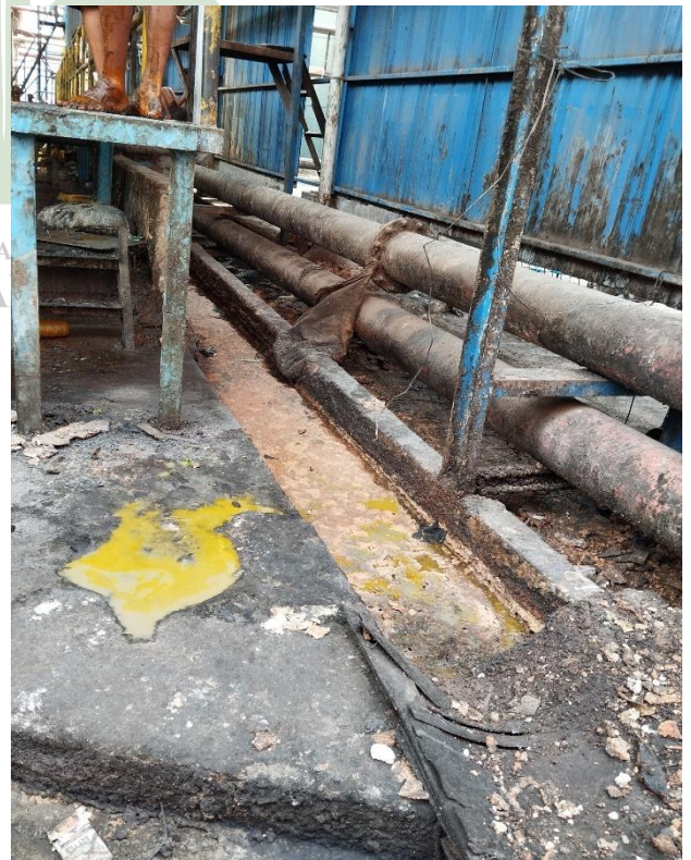
Kondisi Lantai Area Bagian Operasional
