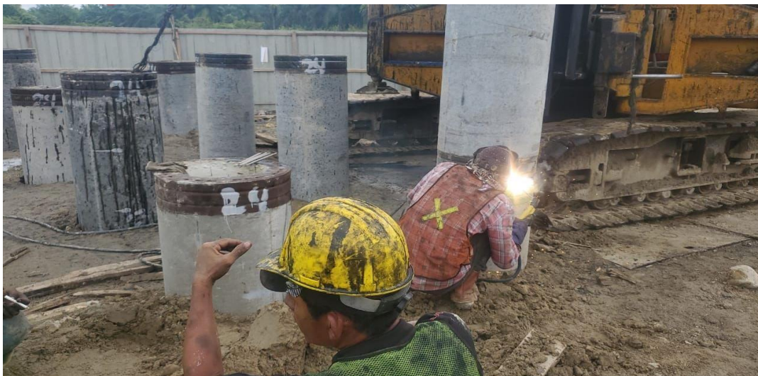
Proses pengelasan borepile (paku bumi) oleh pekerja yang berfungsi sebagai pondasi jembatan jalan tol
