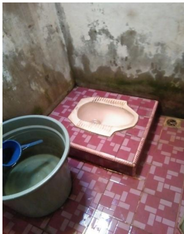
Gambar 9. Kamar Mandi dan Jamban
