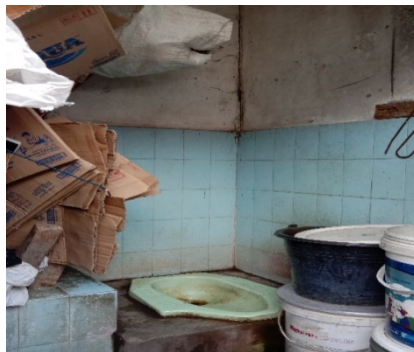
Foto 4.2 Jamban Tidak Memenuhi Syarat
