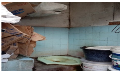
Foto 4.4 Tidak Tersedia Air
