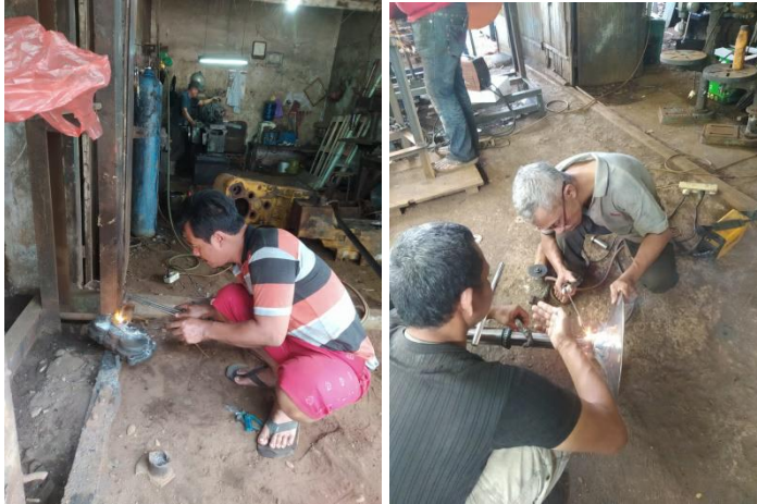
Pekerja yang tidak menggunakan APD pada saat proses pengelasan
