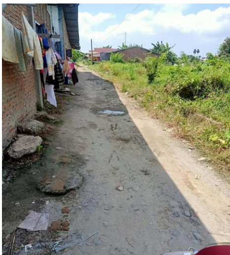
Ket. Jalan gang yang tidak kunjung dibangun
