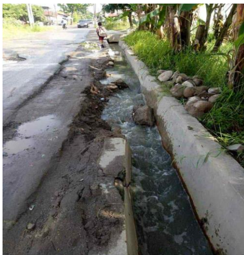
Ket. Drainase yang rusak
