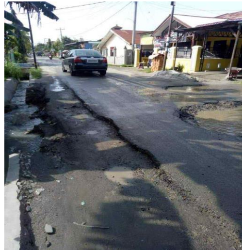
Ket. Drainase yang rusak
