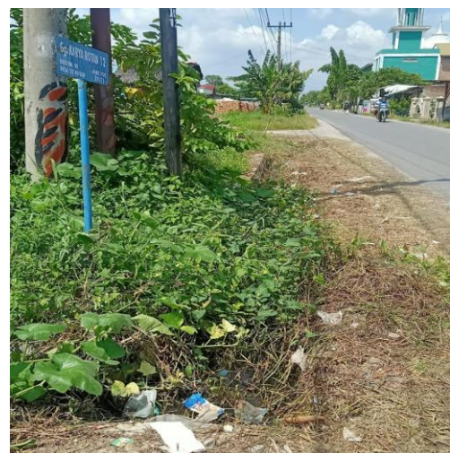
Ket. Kondisi Drainase yang terbengkalai
