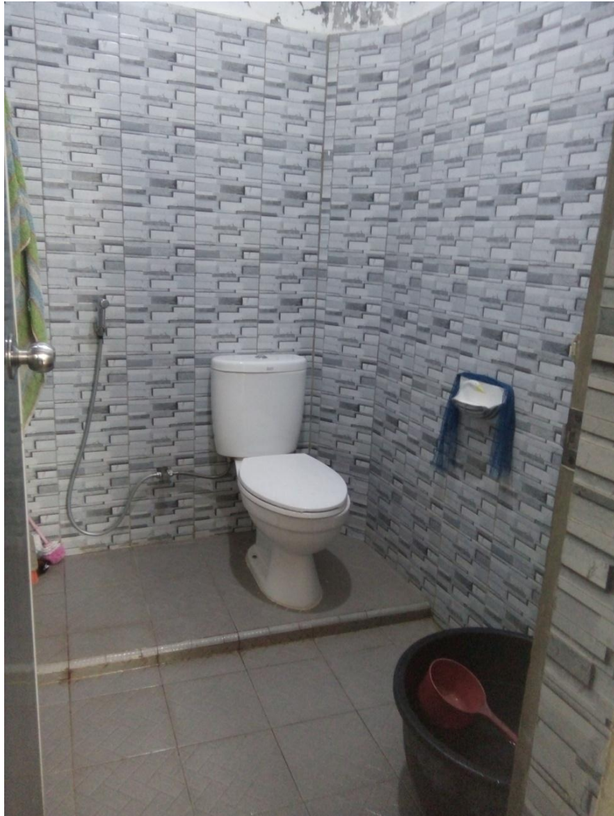
Gambar 3 Kondisi toilet perempuan
